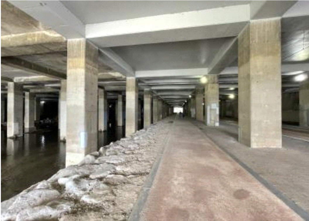
<그림 16> 대림동 646-1 내 교량 하부
